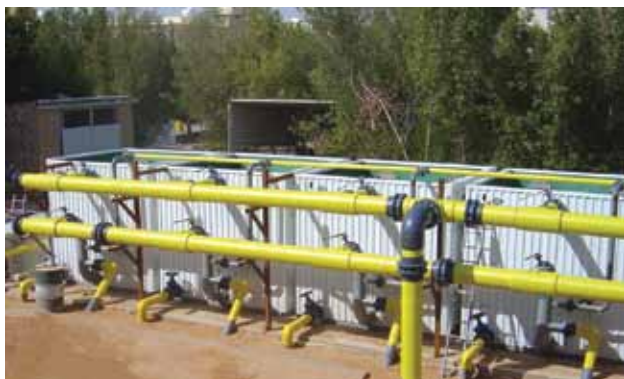
Рисунок 1 Очистные сооружения «Аль-Джазира».
